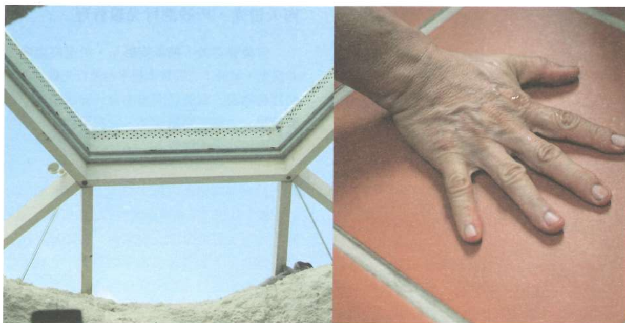
天井窗框上的排氣小孔，讓屋內產生強迫對流。
