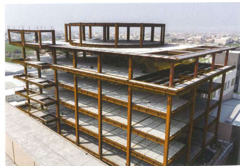
鋼構工程在整個工程生命週期中，扮演領頭羊角色，完工後其他工項隨即登場。
