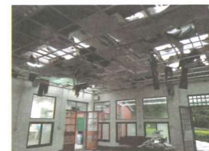
屋頂破損、全數設備家具皆報銷的禮堂
