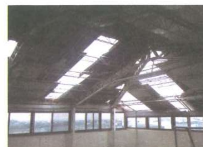
遭梅姬颱風重創嚴重破損的活動中心屋頂
