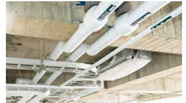
吊頂空間下配置空調管線
