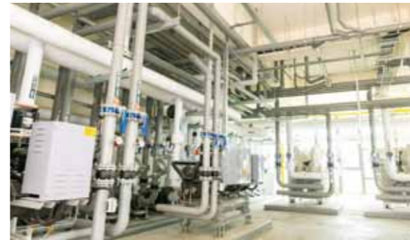
寬敞的主機機房，設備維護一目了然
