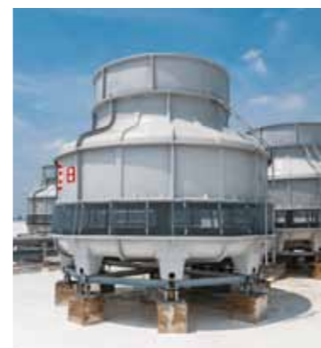
置於工廠頂樓的冷卻水塔
