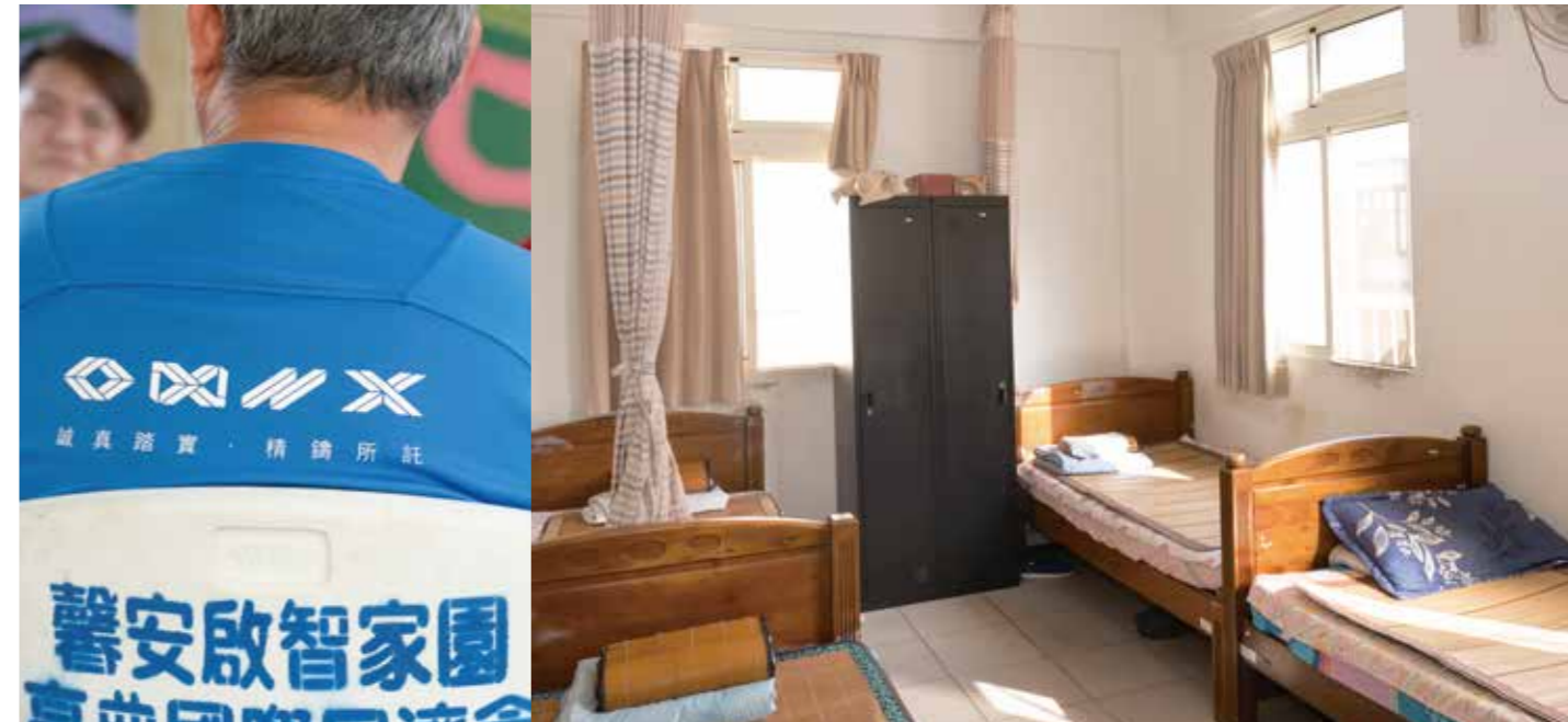
原本壁癌汙損最嚴重的天花板處，在晨繕團的協助下，現已修復完整
